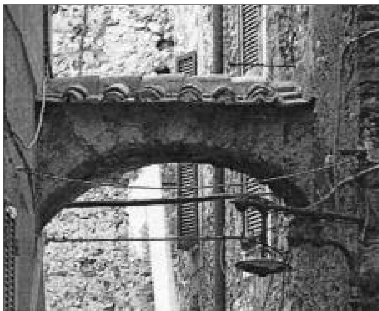
Fig. 4 - ARCHETTO ANTISISMICO CHE SORREGGE DUE FABBRICATI IN VIA DEL SOLE
