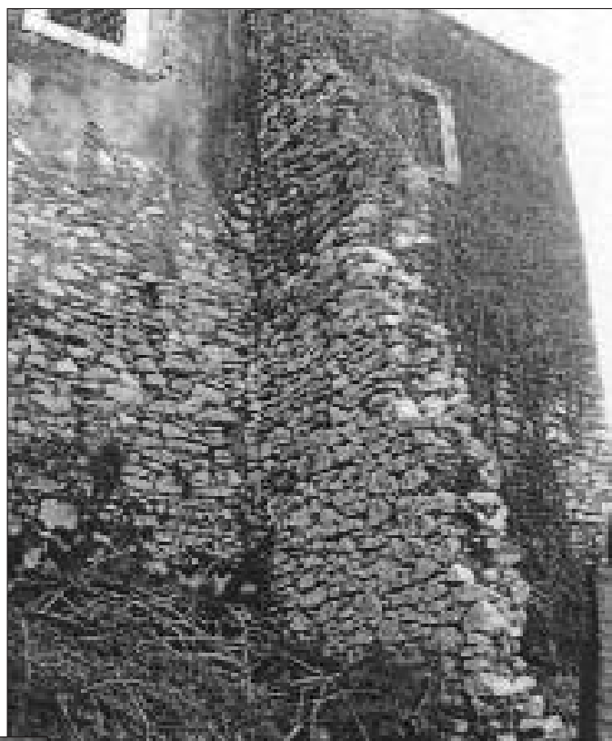
Fig. 6 - SPERONE CHE SORREGGE UN MURO PORTANTE DELLA CHIESA DI SANTA MARIA (LATO W)
