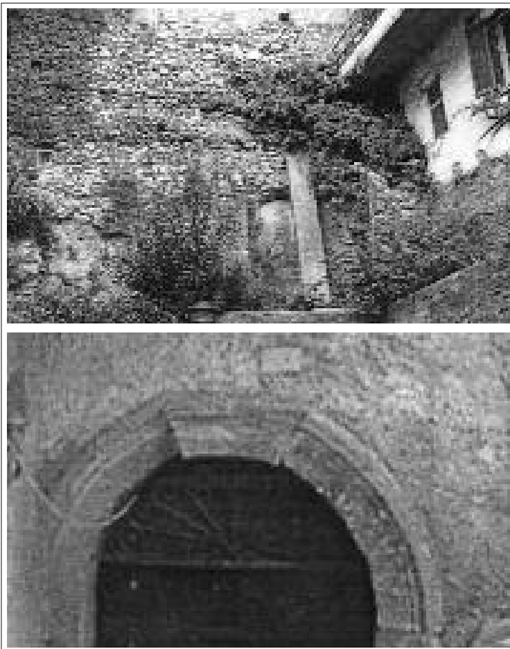
Fig. 5 - TRACCE MURARIE DEL FABBRICATO CROLLATO IN VIA DEL SOLE
